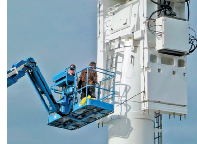
Mit der Arbeitsbühne zum Getrieberaum der Antennenanlage: Arbeiten in 15 Meter Höhe mit dem einen oder anderen kräftigen Windstoß
