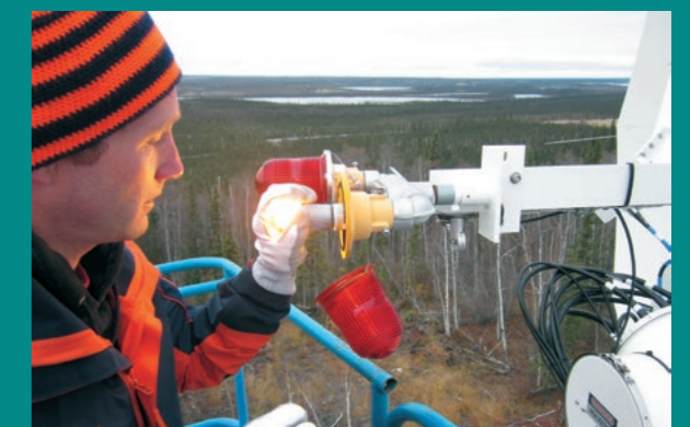
Auch das gehört zur Wartung: Lampenwechsel an der Antenne
